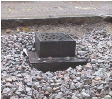
8. grille EP sur caisson d’oxygénation
