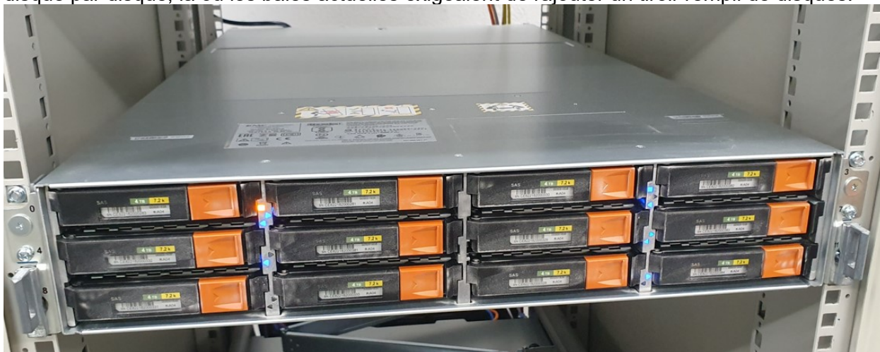
Illustration : une des deux baies de sauvegarde actuelles avec ses disques embarqués
