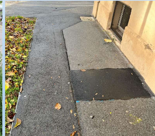
Exemple de tassement de la route au droit des fosses d'arbres et esthétique d'une réfection
