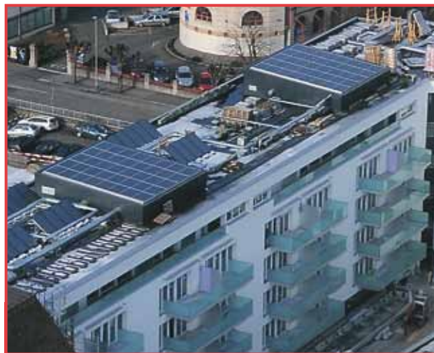
Une impressionnante installation solaire combinant thermique et photovoltaïque installée sur la toiture du bâtiment
