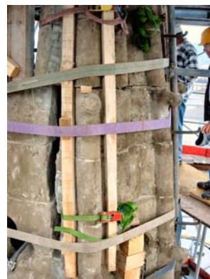
Mesures urgentes de sécurisation de la flèche du clocher après l'ouragan du 18 juillet 2005
