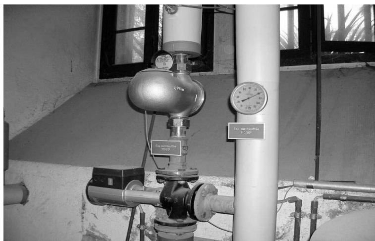
Installation technique - local de chauffage au rez-de-chaussée
