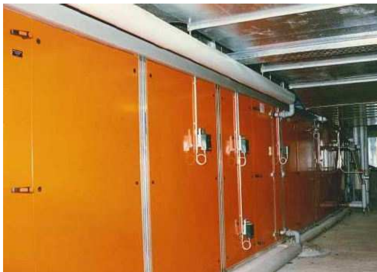
Installation de ventilation existante
