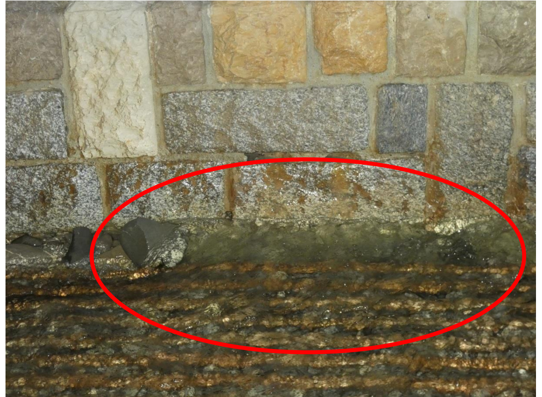
Voûtage des Toveires : Dégât sur banquette en béton hte résistance
