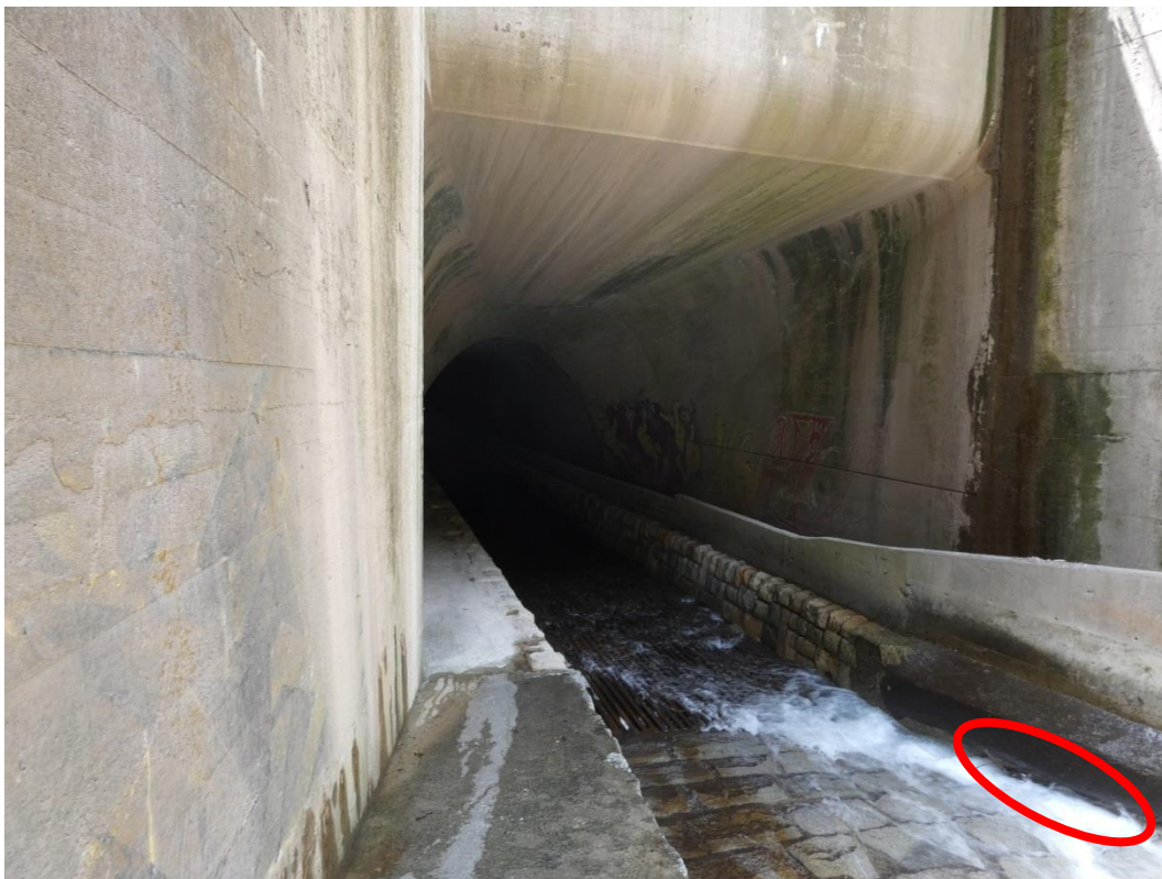
Voûtage des Toveires : Dégât au portail d'entrée
