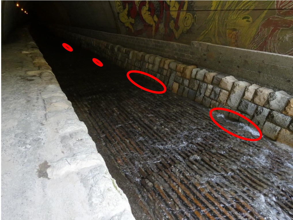
Voûtage des Toveires : Dégâts sur banquettes en béton hte résistance
