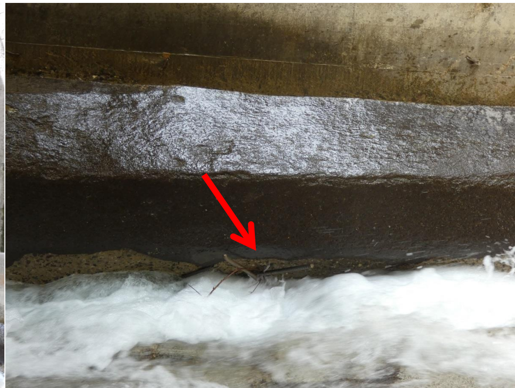
Usure du béton et dégât sur armature apparente
