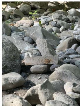
Photo 3 – Éléments métallique rouillé présent entre les blocs du lit de la Veveyse.
