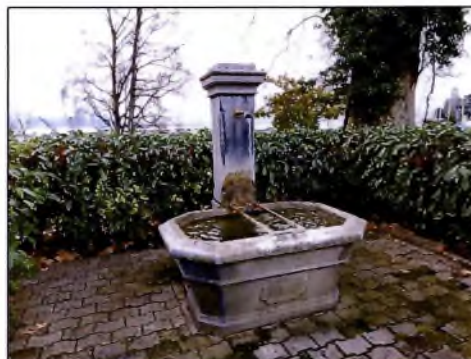
Point de contrôle sur le réseau de distribution, fontaine, Clarens
