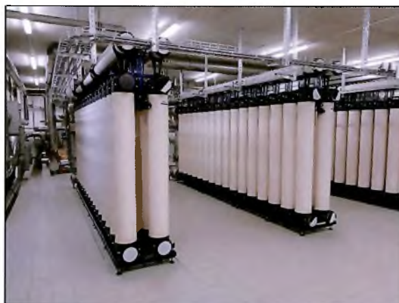
Modules d'ultrafiltration, station de traitement des Avants
