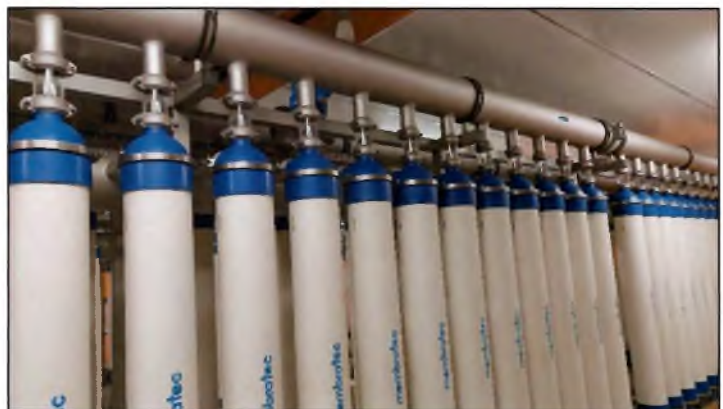
Etape d'ultrafiltration, station des Gonelles
